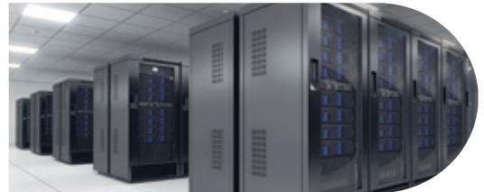
GRANDI DATA CENTER
